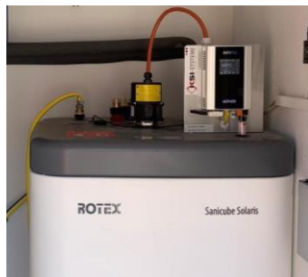
Als Wärmespeicher fungiert ein ROTEX Sanicube mit 2 x 3kW Heizelement.
