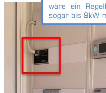
Überschussmessung mit dem my-PV Power Meter.
