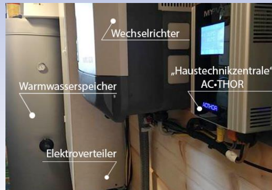
Abbildung: Die gesamte Haustechnik auf kleinstem Raum
