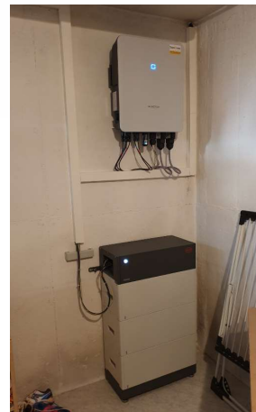
Sungrow Wechselrichter SH 8RT mit 7,68 kWh BYD Batteriespeicher
