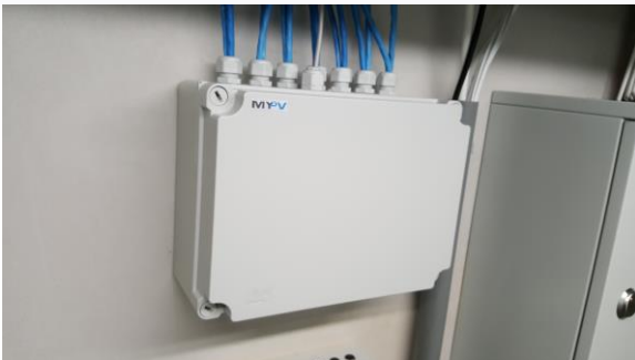
Abbildung 1: Cloud Connect Einheit mit Datenkabeln zu den ELWAs in den Wohnungen
