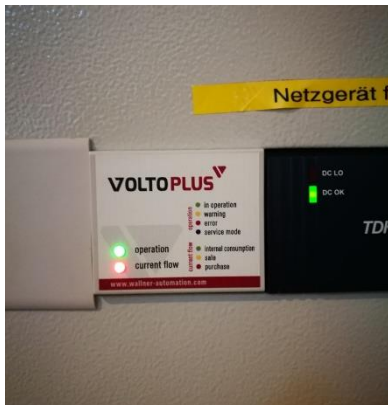
Bild: Einbausituation im Verteiler
