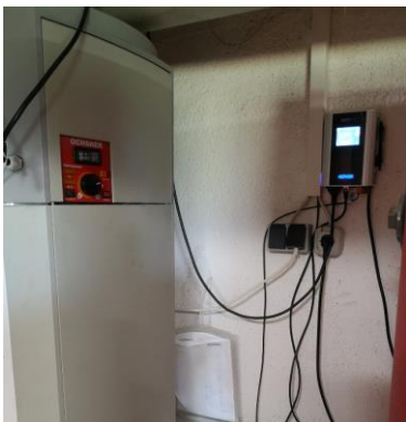
Der AC•THOR regelt den Heizstab einer Wärmepumpe. Dieser ist zuvor von der Wärmepumpensteuerung getrennt worden.
