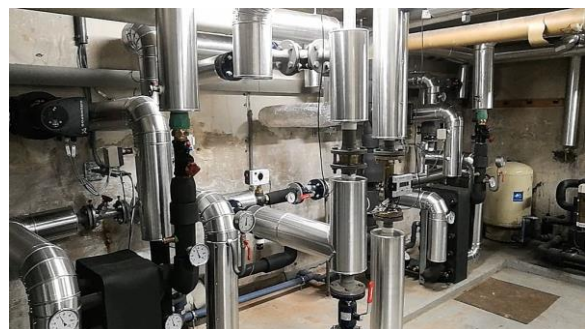
Abbildung 3: Übergabe an das Fernwärmenetz
