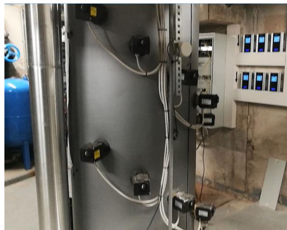
Abbildung 2: Wärmespeicher mit my-PV Einschraubheizkörper
