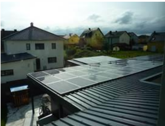
Abbildung 4: Photovoltaikanlage am Garagendach
