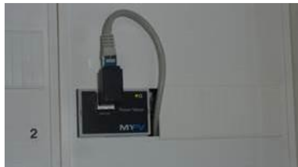
Abbildung 3: Der Power Meter wird direkt nach dem Zähler des Energieversorgers im Verteiler schrank montiert.
