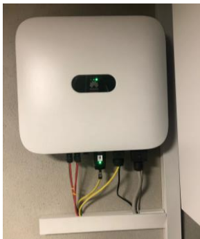
Der AC•THOR 9s erhält die Leistungsvorgabe von Huawei ohne Netzwerk über Modbus RTU.
