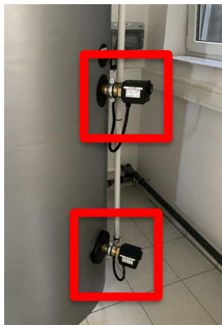
Die abwechselnde Regelung der zwei 9 kW Einschraubheizkörper von my-PV ermöglicht eine thermisch optimierte Erwärmung des 750 Liter Speichers
