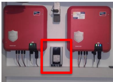
Der AC•THOR 9s macht die Hydraulikeinheit Tuxhorn tubra eTherm C (rechts) stufenlos regelbar und somit „PV-ready“.
