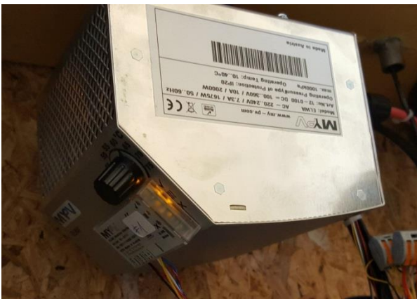
Abbildung 5: ELWA mit Datenschnittstelle für Anlagenüberwachung
